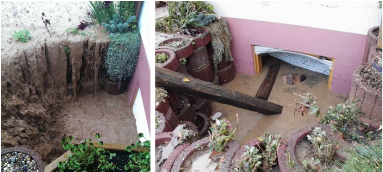
Abb. 17: Überflutete Souterrainwohnung im Moscheltal 2014, Foto: Schultheiß
