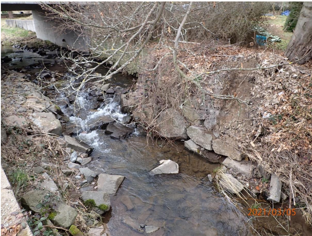
Abb. 74: Potenziell instabile Ufermauer
