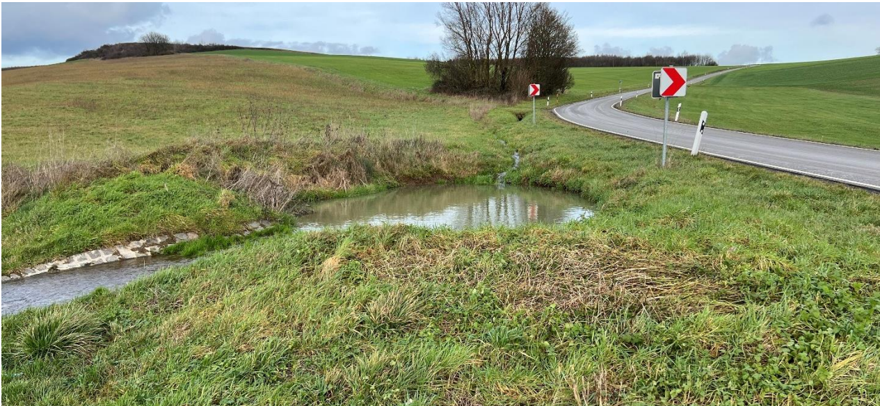
Abb. 14: Beispiel für Kleinrückhalt und Umleitung von Außengebietswasser
