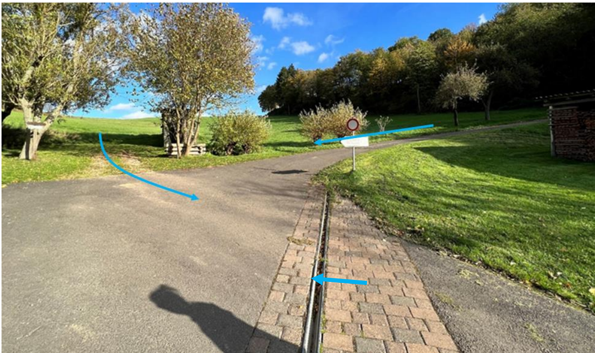
Abb. 37: Entwässerungseinrichtungen am oberen Ende der Straße Sportplatzweg
