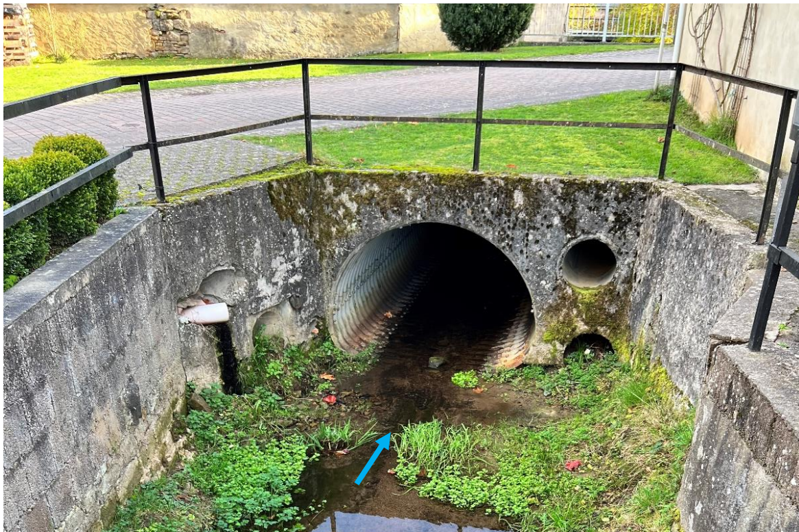
Abb. 29: Durchlass Straße Oberdorf/Perlbachweg mit Unterhaltsbedarf Örtliches Hochwasser- und Starkregenvorsorgekonzept Kappeln
