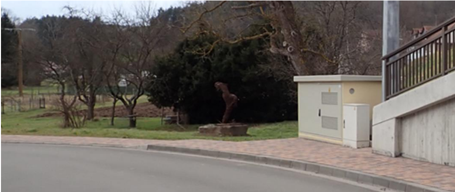
Abb. 8: Trafostation im überflutungsgefährdeten Bereich des Jeckenbachs
