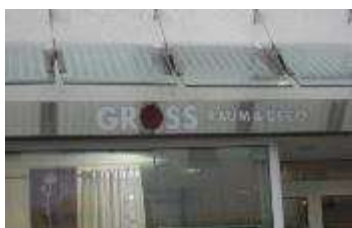
Abbildung 26: positives Beispiel: Glasvordach
