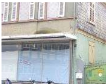
Abbildung 25: negatives Beispiel: Betonvordach
